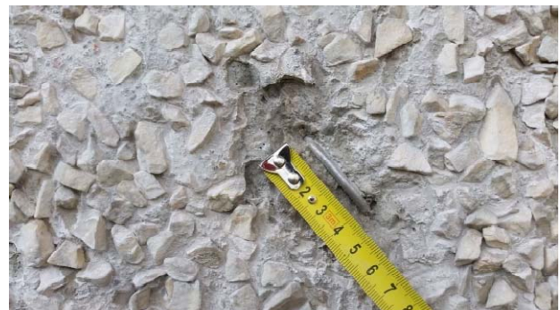
Fig. 9 Visible steel pin.
